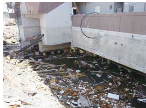
残存建築物周囲の洗掘状況
